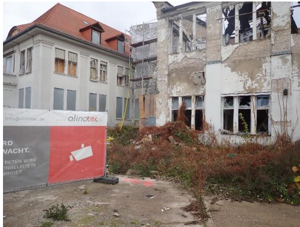
Bild 3-2 Denkmalgeschütztes Gebäude auf der linken Seite und abrisssreifes Gebäude auf der rechten Seite
